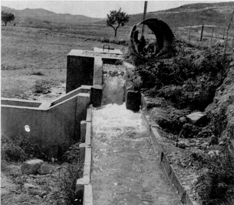
Figura 2.—Salida de la arqueta de distribución. Canal del Grupo Sindical, Sector SW.
