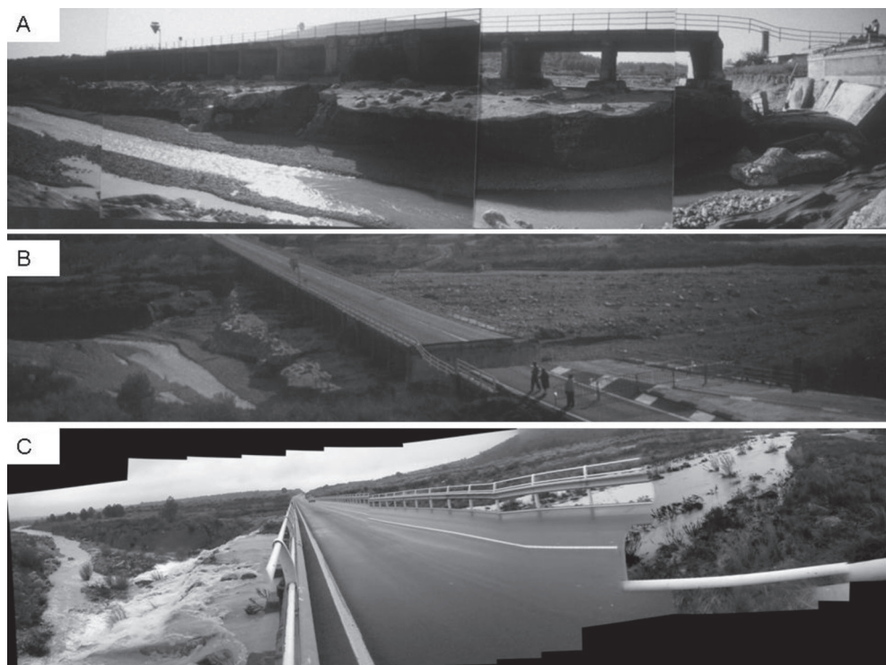
Figura 6. El pont de la rambla de Cervera al pas de la CV-132. El descàlçament del pont era ben palès des dels anys 1980, però va ser a la riuada d'octubre de 2000 quan va caure (A i B). A la riuada del 30 de novembre de 2014, el descàlçament ha continuat malgrat que el pont ha estat reconstruït i novament reforçat (C).
